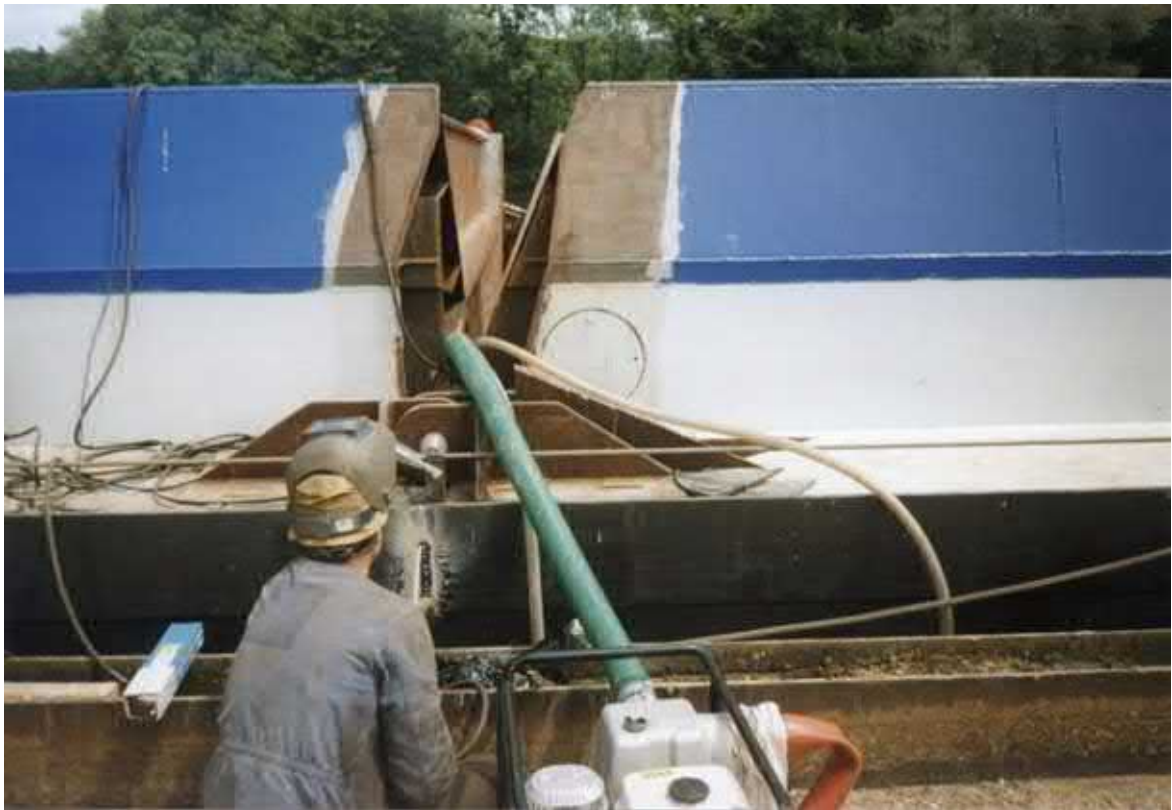
Lavori di saldatura fuoribordo. Dall'interno deve essere pompata continuamente acqua Photo: © Uwe Mayer / Marti AG
